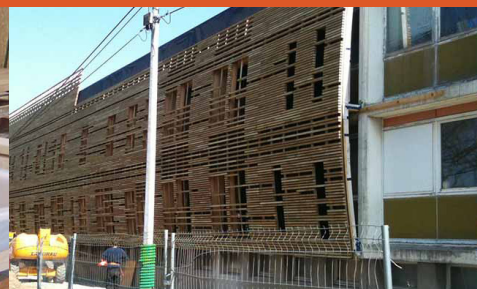
La forme des façades permet le passage des gaines de ventilation
